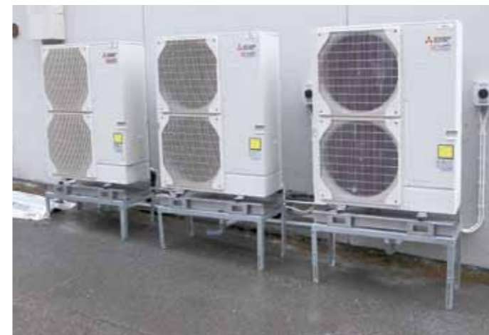
Kolme ilma-vesilämpöpumppea tuovat lisätehoa As Oy Terävänmäen lämmitykseen.
