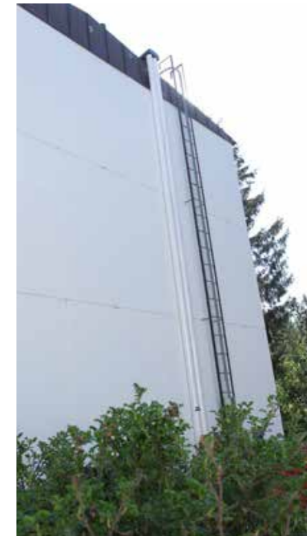
Osaan taloista on asennettu PILP-järjestelmä, jonka putkituksia on sijoitettu kiinteistön päätyseinälle.
